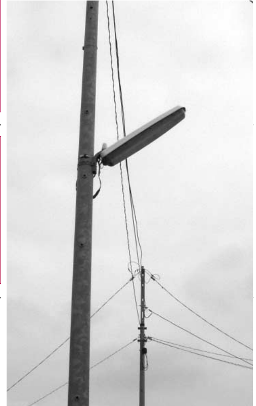
防犯灯管理をシステム化
