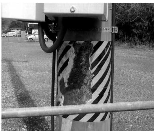
老朽化した防災無線柱
