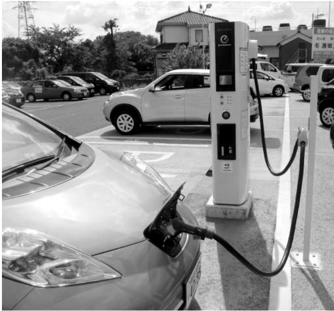
急速充電設備（久喜市内）
