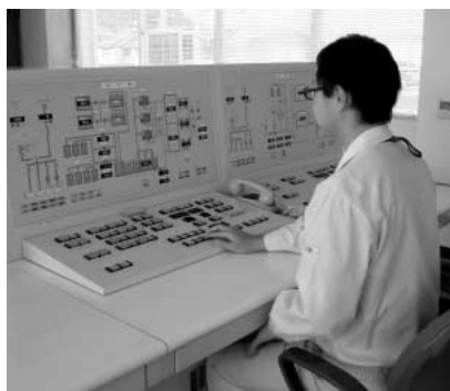
上水場の管理システム
