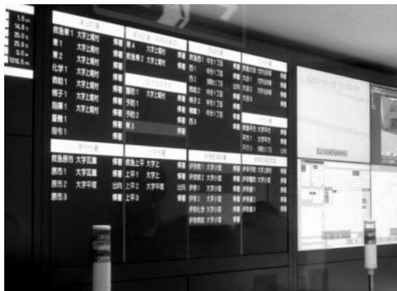
消防通信指令業務の共同運用開始 消防の広域化は、今後の重要な課題
