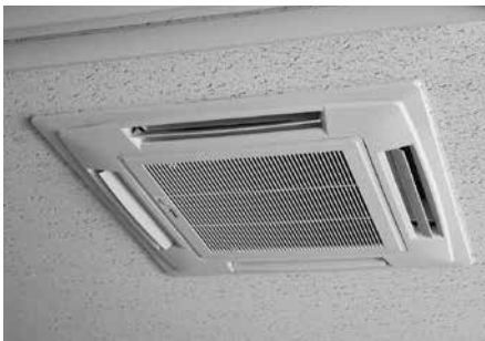
小針北小の新設されたエアコン
