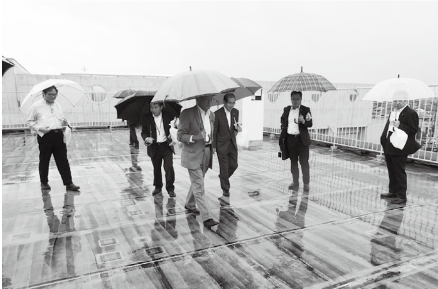
小針小学校の雨漏り状況の確認
