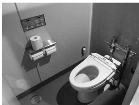
松伏町の学校のトイレ
