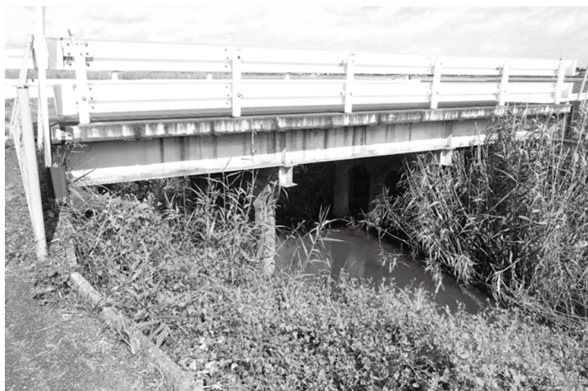
補修が必要な大針橋
