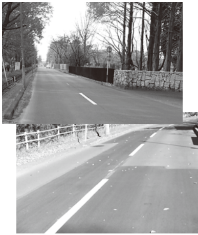
薬科大学前 町道7号線 本年度は測量および詳細設計を行い、来年度に全面打ち替え工事予定となった
