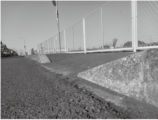
栄南区のマウントアップ型歩道 勾配が急で危険
