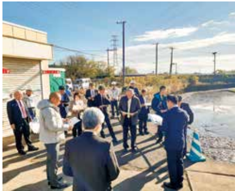
浚渫工事中の第二調整池にて、関係者から説明を受ける
