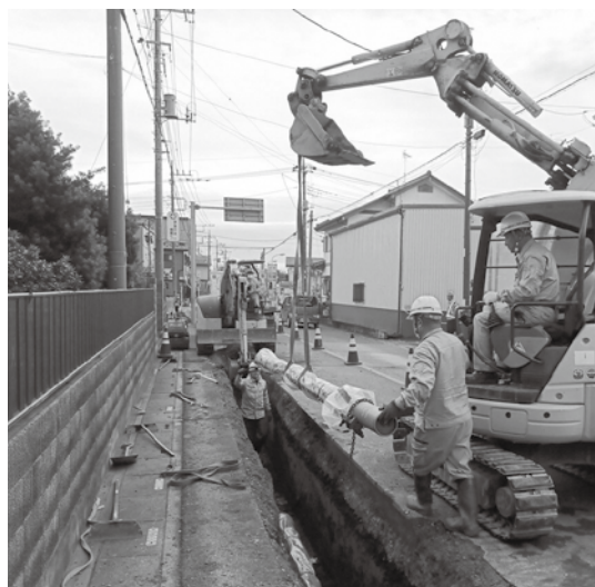
令和5年度の例：水道管100mm250m/3,300万円。費用負担の大きい埋設配管更新
