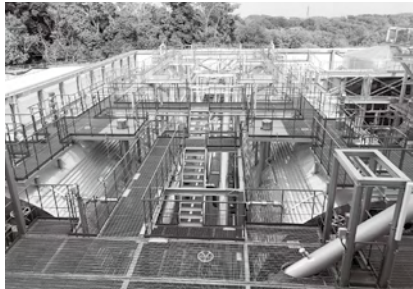
▶ 乾式高温メタン発酵のバイオガス化施設
