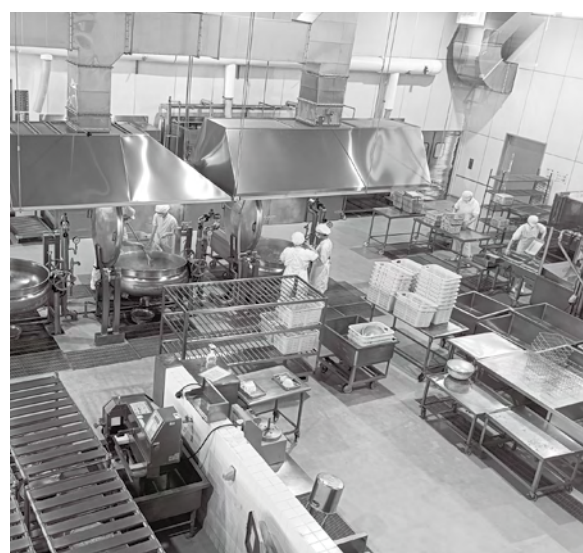
築31年を経過した給食センターは、設備の老朽化が…
