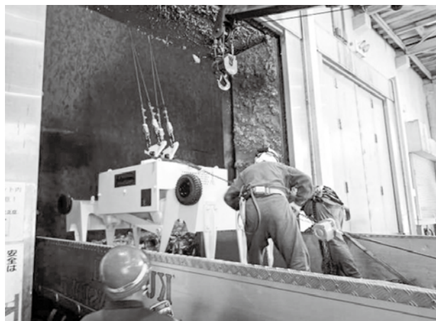
新たなごみ処理施設完成予定の令和15年まで維持させるために、3ヶ年計画で行われた町クリーンセンターの基幹的設備改良事業(7億4,378万円)
